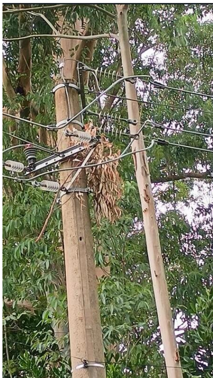
Figura 23- Evidência de Campo Canoas, Município de Gravataí- Fonte: CPFL RGE
