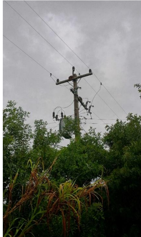
Figura 36- Evidência de Campo Estrela, Vale do Taquari- Fonte: CPFL RGE
