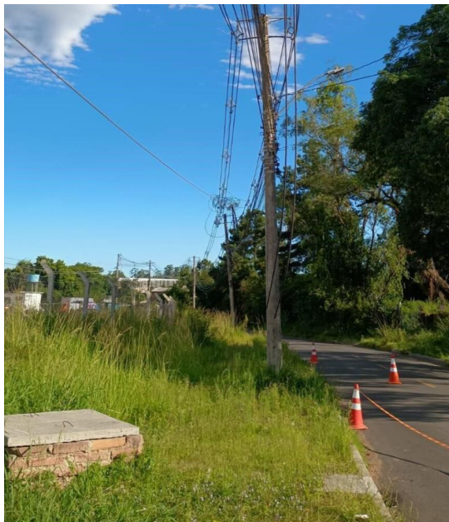
Figura 24 – Evidência de Campo Canoas, Município de Gravataí- Fonte: CPFL RGE
