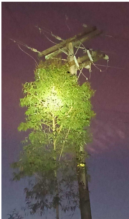
Figura 42- Evidência de Estância Velha, Vale dos Sinos - Fonte: CPFL RGE
