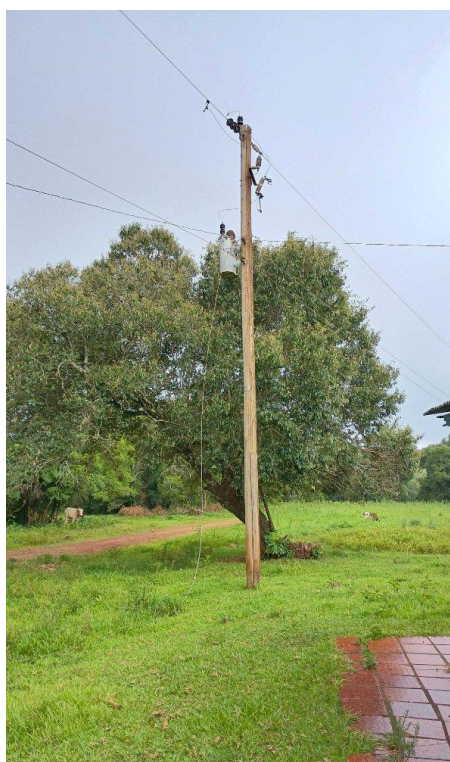
Figura 60- Evidência de Redentora, Norte - Fonte: CPFL RGE
