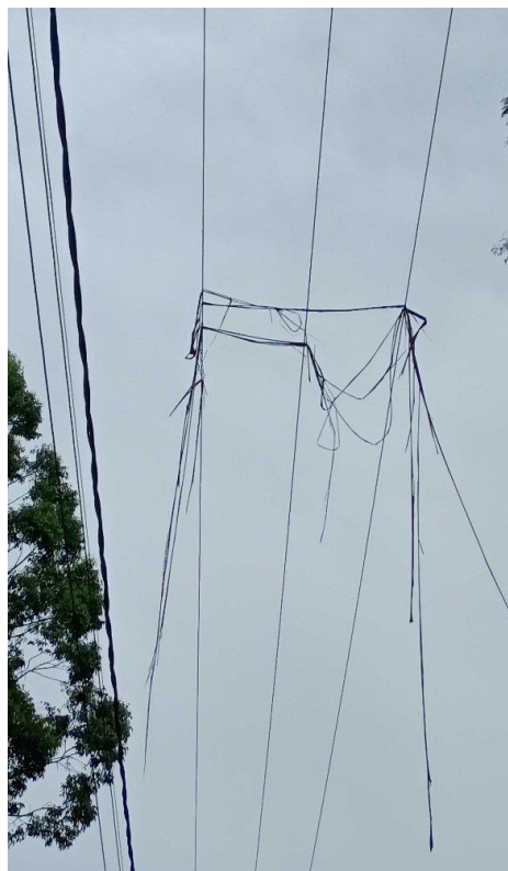
Figura 49- Evidência de São Leopoldo, Vale dos Sinos - Fonte: CPFL RGE
