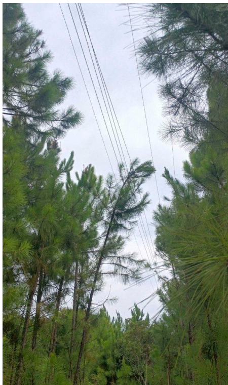
Figura 50- Evidência de Canoas, Gravataí - Fonte: CPFL RGE
