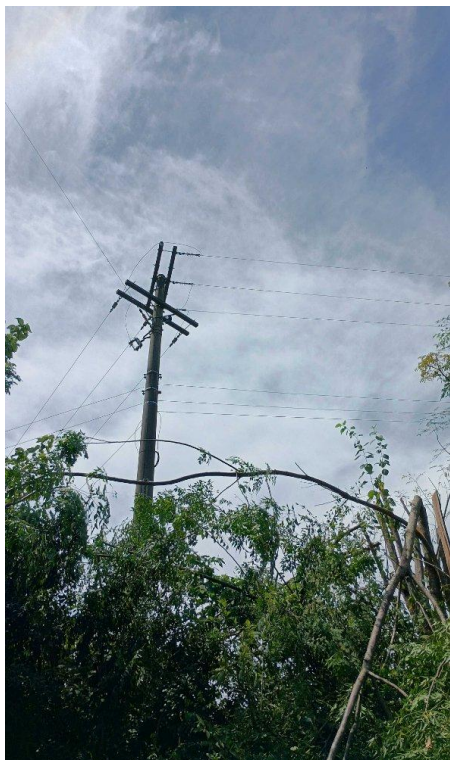
Figura 58- Evidência de Trindade do Sul, Norte - Fonte: CPFL RGE
