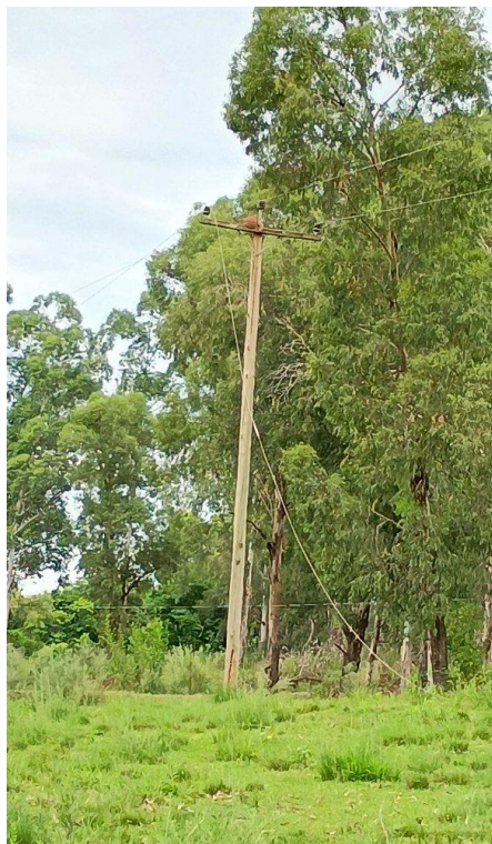
Figura 59- Evidência de Itaqui, Missões - Fonte: CPFL RGE
