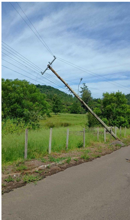
Figura 54- Evidência de Estância Velha, Vale dos Sinos - Fonte: CPFL RGE
