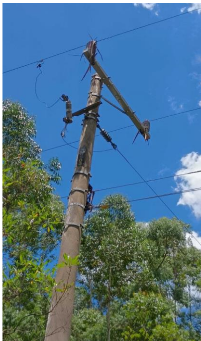
Figura 29- Evidência de Campo Canoas, Município de Gravataí - Fonte: CPFL RGE
