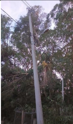
Figura 24 - Evidência de Campo – Sudeste, Jundiaí/SP – Fonte: CPFL Piratininga
