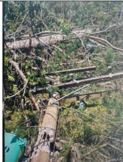
Figura 21 - Evidência de Campo – Sul, Ibiúna/SP –Fonte: CPFL Piratininga
