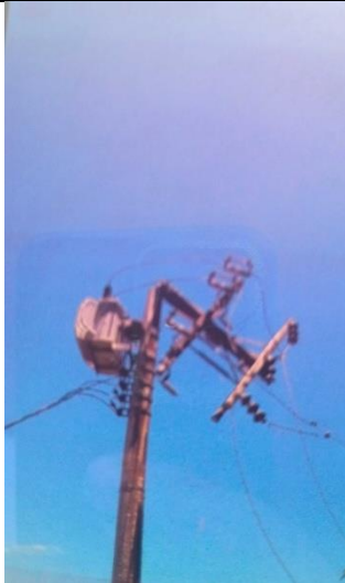
Figura 40 - Evidência de Campo - Sul, Ibiúna/SP –Fonte: CPFL Piratininga
