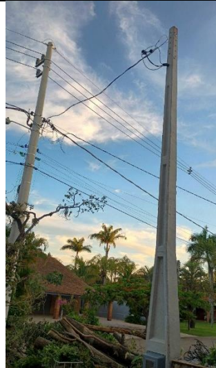
Figura 19 - Evidência de Campo – Sul, Sorocaba/SP –Fonte: CPFL Piratininga
