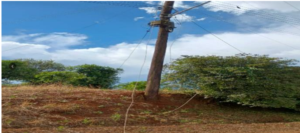
Figura 26 - Registro Fotográfico – Fonte: CPFL RGE
