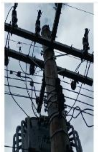
Figura 19 - Registro Fotográfico – Fonte: CPFL RGE
