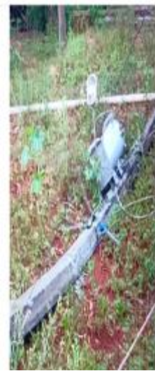
Figura 20 - Registro Fotográfico – Fonte: CPFL RGE
