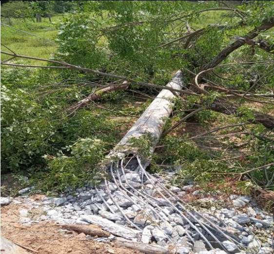
Figura 27 - Evidência de Campo - Sul, Sorocaba/SP – Fonte: CPFL Piratininga
