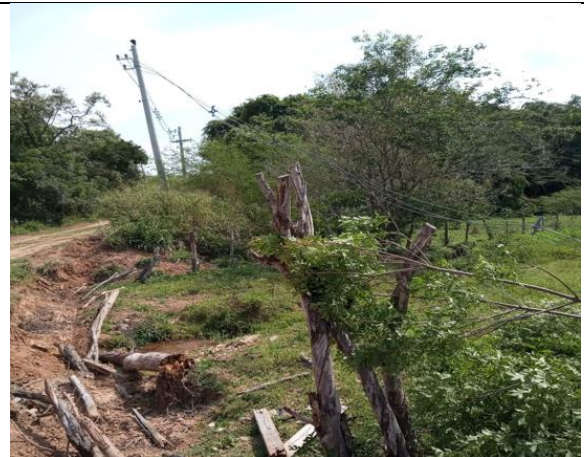
Figura 26 - Evidência de Campo - Sul, Sorocaba/SP – Fonte: CPFL Piratininga
