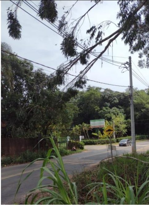
Figura 17 - Evidência de Campo - Sudeste, Jundiaí/SP – Fonte: CPFL Piratininga
