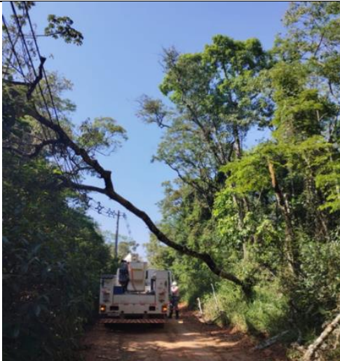
Figura 35 - Evidência de Campo - Sul, São Roque/SP – Fonte: CPFL Piratininga
