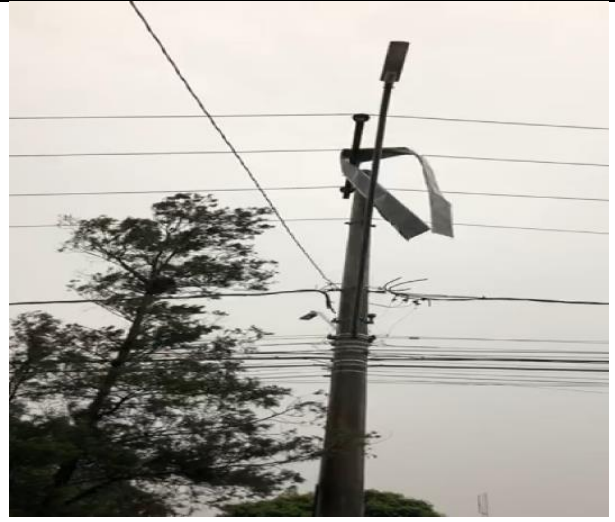
Figura 28 - Evidência de Campo - Sul, Sorocaba/SP – Fonte: CPFL Piratininga
