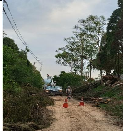
Figura 24 - Evidência de Campo - Sul, Sorocaba/SP – Fonte: CPFL Piratininga
