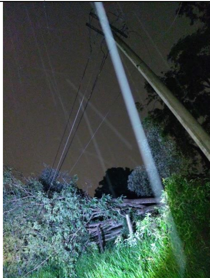
Figura 75 - Evidência de Campo - Leste, Campinas/SP – Fonte: CPFL Paulista
