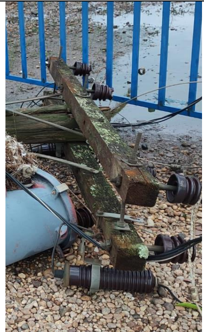
Figura 36 - Evidência de Campo – Centro, Jaú/SP – Fonte: CPFL Paulista
