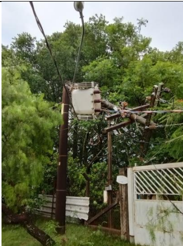
Figura 89 - Evidência de Campo - Oeste, São Manoel/SP – Fonte: CPFL Paulista
