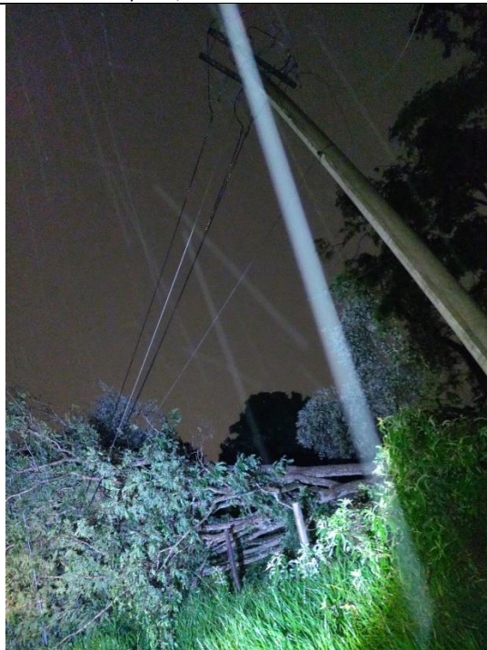
Figura 77 - Evidência de Campo - Leste, Campinas/SP – Fonte: CPFL Paulista
