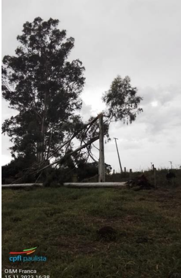
Figura 45 - Evidência de Campo - Nordeste, Franca/SP – Fonte: CPFL Paulista
