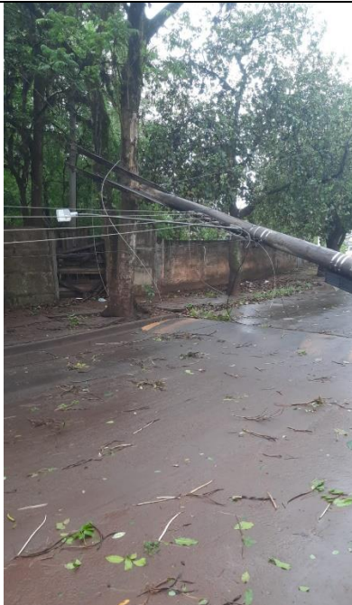
Figura 35 - Evidência de Campo – Centro, Jaú/SP – Fonte: CPFL Paulista
