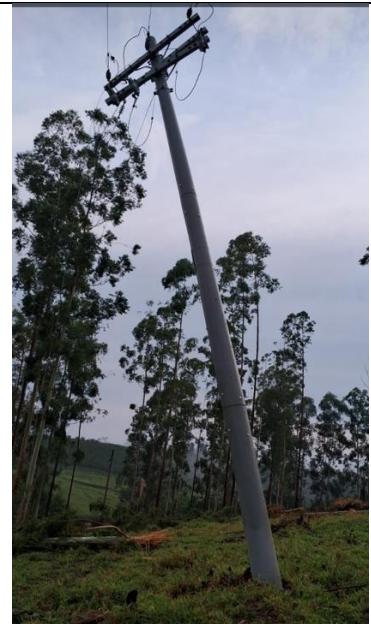
Figura 70 - Evidência de Campo - Leste, Águas de Lindóia/SP – Fonte: CPFL Paulista
