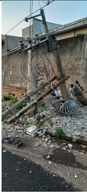
Figura 52 - Evidência de Campo - Centro Norte, Jaboticabal/SP – Fonte: CPFL Paulista
