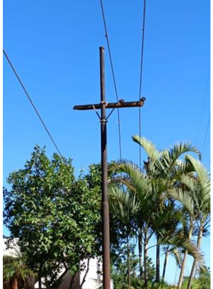
Figura 89 - Evidência de Campo - Oeste, Botucatu/SP – Fonte: CPFL Paulista
