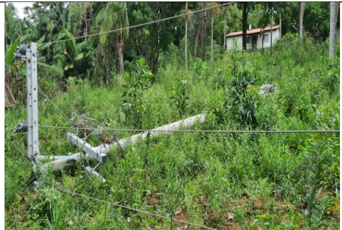
Figura 81 - Evidência de Campo - Leste, Socorro/SP – Fonte: CPFL Paulista
