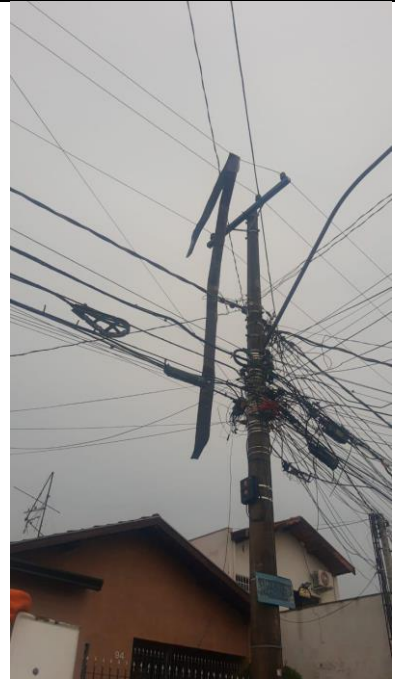
Figura 67 - Evidência de Campo – Centro Sul, Piracicaba/SP – Fonte: CPFL Paulista
