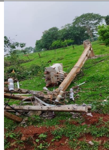
Figura 39 - Evidência de Campo - Nordeste, Igarapava/SP – Fonte: CPFL Paulista
