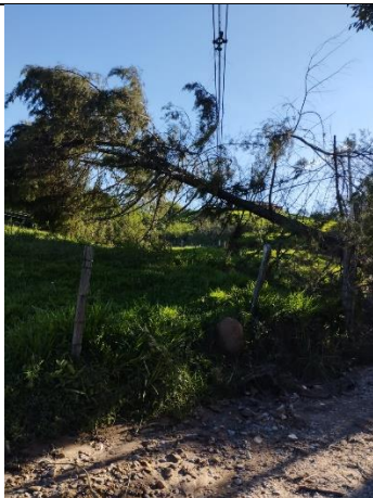
Figura 80 - Evidência de Campo - Leste, Socorro/SP – Fonte: CPFL Paulista
