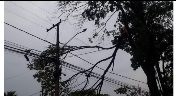
Figura 63 - Evidência de Campo - Ourinhos, Ribeirão Claro/SP – Fonte: CPFL Santa Cruz
