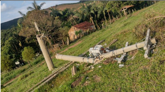
Figura 34 - Evidência de Campo – SJ Rio Pardo, São José do Rio Pardo/SP – Fonte: CPFL Santa Cruz
