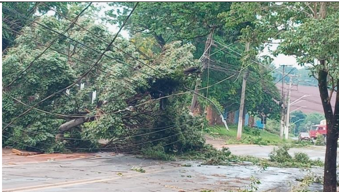
Figura 64 - Evidência de Campo - Ourinhos, São Pedro do Turvo/SP – Fonte: CPFL Santa Cruz
