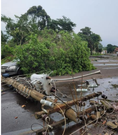
Figura 20 – Evidência de Campo - Itapetininga, Itapetininga/SP – Fonte: CPFL Santa Cruz
