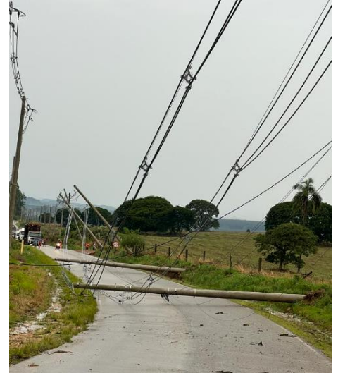
Figura 21 - Evidência de Campo - Itapetininga, Itapetininga/SP – Fonte: CPFL Santa Cruz
