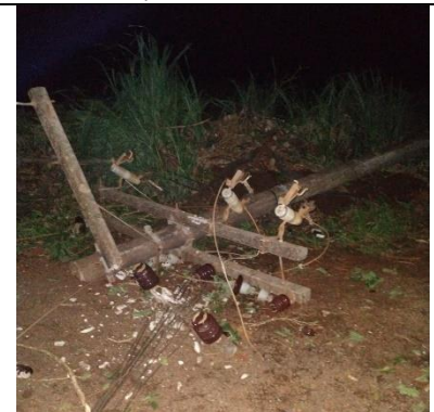
Figura 65 - Evidência de Campo - Ourinhos, Ribeirão Claro/SP – Fonte: CPFL Santa Cruz
