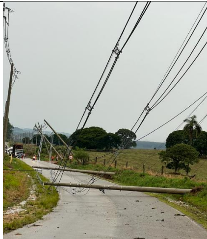
Figura 18 - Evidência de Campo - Itapetininga, Itapetininga/SP – Fonte: CPFL Santa Cruz
