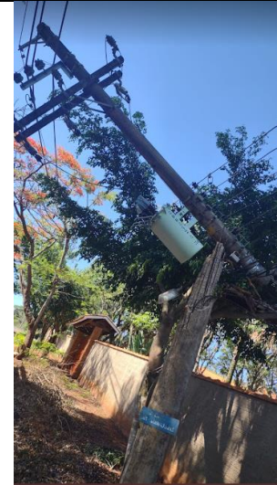
Figura 31 - Evidência de Campo – Avaré, Avaré/SP – Fonte: CPFL Santa Cruz
