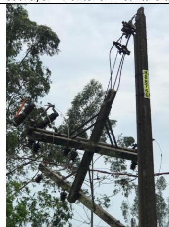
Figura 27 - Evidência de Campo – Itapetininga, Sarapuí/SP – Fonte: CPFL Santa Cruz
