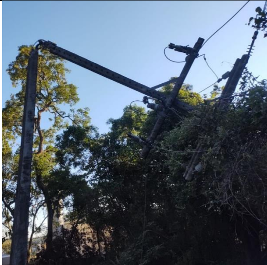
Figura 30 - Evidência de Campo – Avaré, Avaré/SP – Fonte: CPFL Santa Cruz
