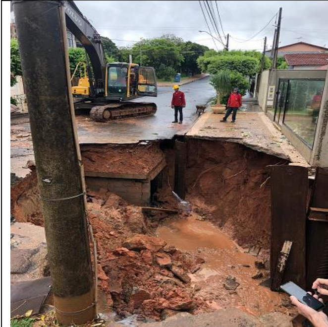
Figura 49 - Evidência de Campo - Norte, São José do Rio Preto/SP – Fonte: CPFL Paulista
