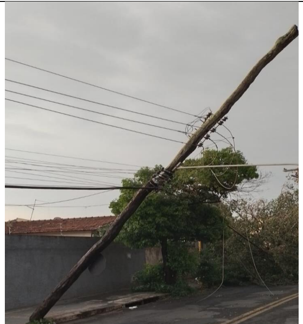
Figura 30 - Evidência de Campo – Centro Sul, Piracicaba/SP – Fonte: CPFL Paulista
