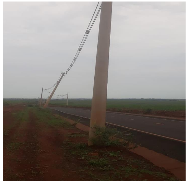
Figura 48 - Evidência de Campo - Norte, Guaira/SP – Fonte: CPFL Paulista
