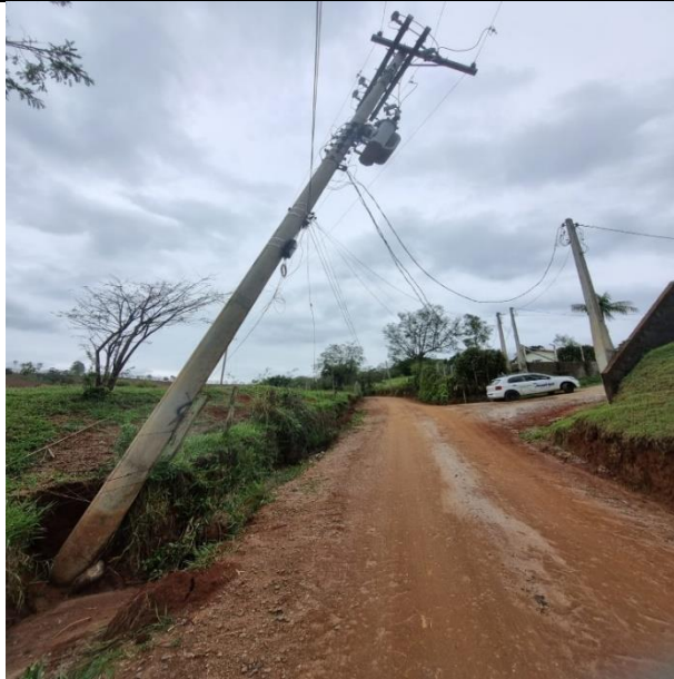
Figura 37 - Evidência de Campo - Leste, Socorro/SP – Fonte: CPFL Paulista
