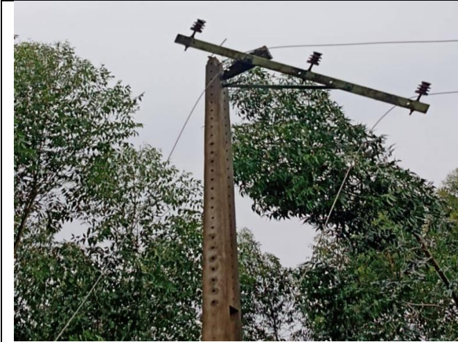
Figura 53 - Evidência de Campo - Oeste, Botucatu/SP – Fonte: CPFL Paulista
