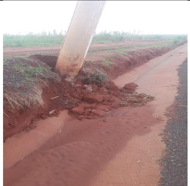
Figura 52 - Evidência de Campo - Norte, Guaira/SP – Fonte: CPFL Paulista
