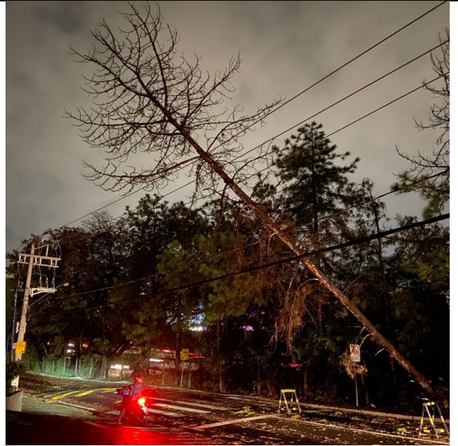
Figura 43 - Evidência de Campo - Leste, Campinas/SP – Fonte: CPFL Paulista
