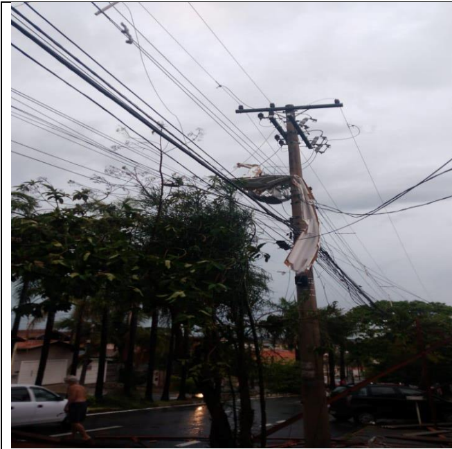
Figura 38 - Evidência de Campo – Centro Sul, Piracicaba/SP – Fonte: CPFL Paulista
