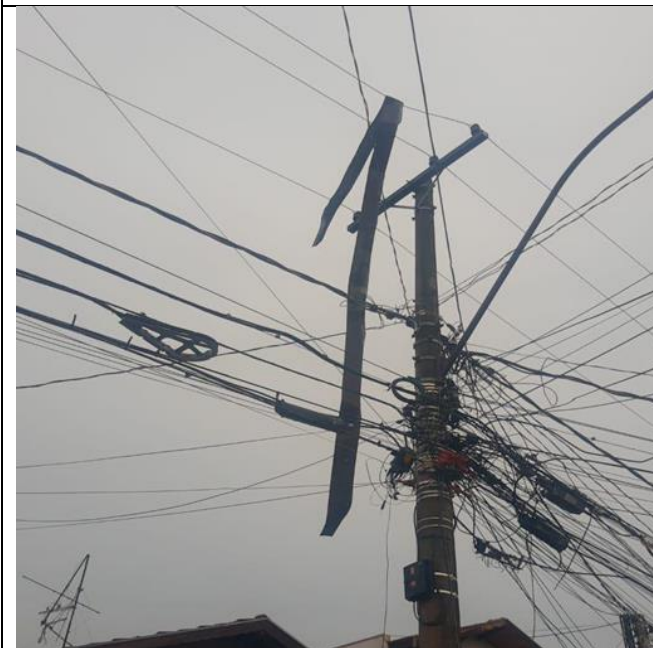
Figura 40 - Evidência de Campo - Centro Sul, Sumaré/SP – Fonte: CPFL Paulista
