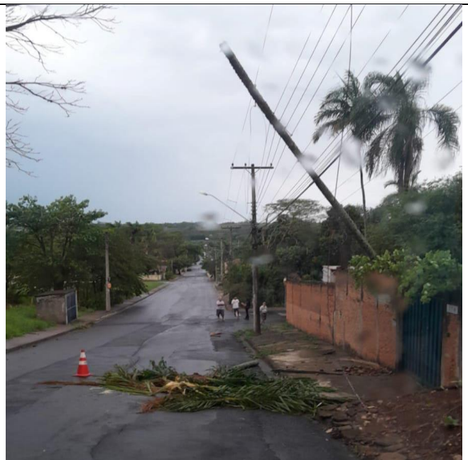
Figura 37 - Evidência de Campo – Centro Sul, Piracicaba/SP – Fonte: CPFL Paulista
