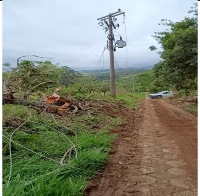
Figura 47 - Evidência de Campo - Leste, Valinhos/SP – Fonte: CPFL Paulista
