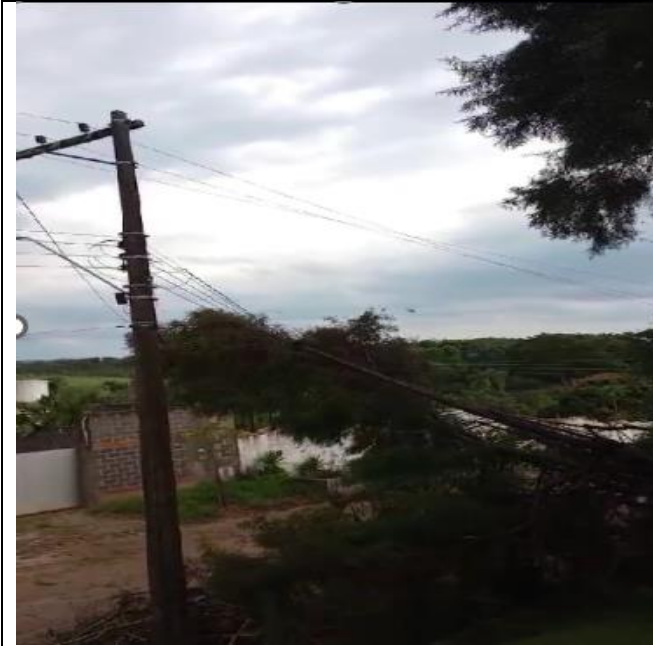
Figura 50 - Evidência de Campo - Leste, Itapira/SP – Fonte: CPFL Paulista
