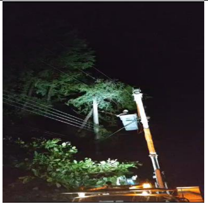
Figura 51 - Evidência de Campo - Leste, Itapira/SP – Fonte: CPFL Paulista
