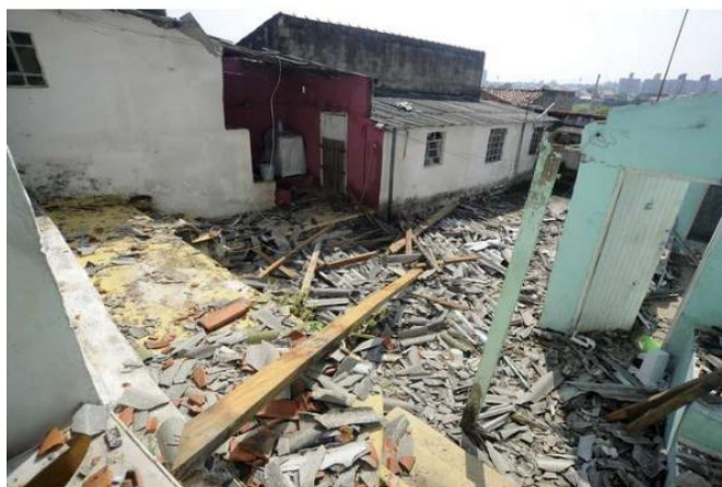
Duas das ocorrências de destelhamento ocorreram na Vila Haro – FÁBIO ROGÉRIO
