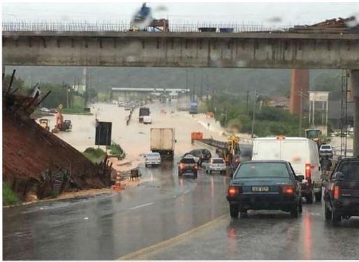
Itens autas registram alagamentos na SP-300 (Foto: Kama TfabasSi BMbosaiTem Você)
